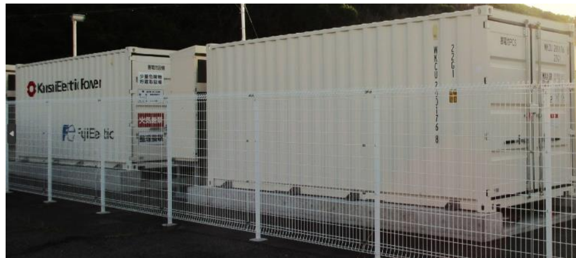
蓄電池およびPCS (20ftコンテナ2基内収容)
