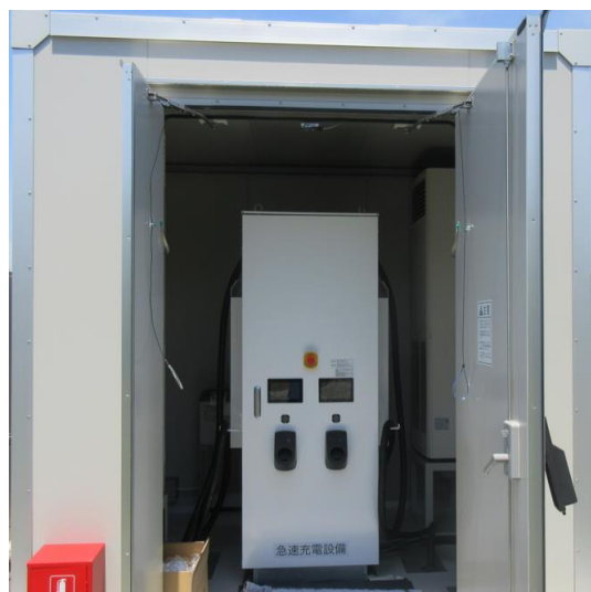
急速充電器 (盤収容)
