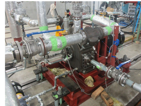
ヒートポンプ用圧縮機試験機
