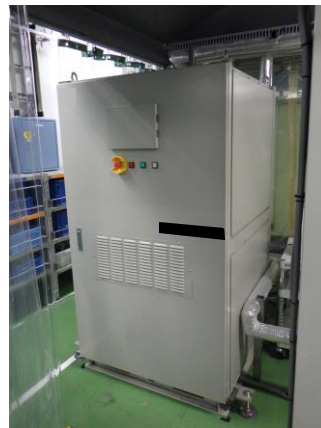
蒸気ヒートポンプ ※温水から蒸気生成
